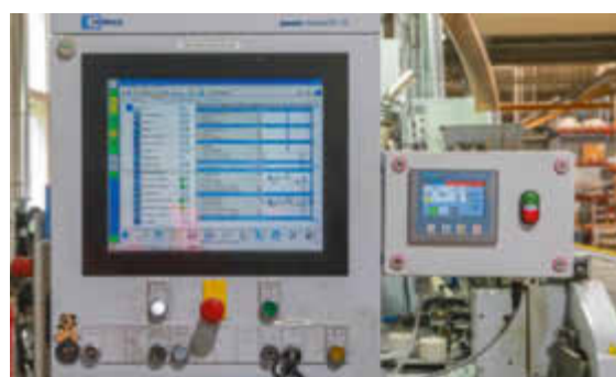
Die Steuerung des Heißluftaggregats sitzt direkt neben der Maschinensteuerung
